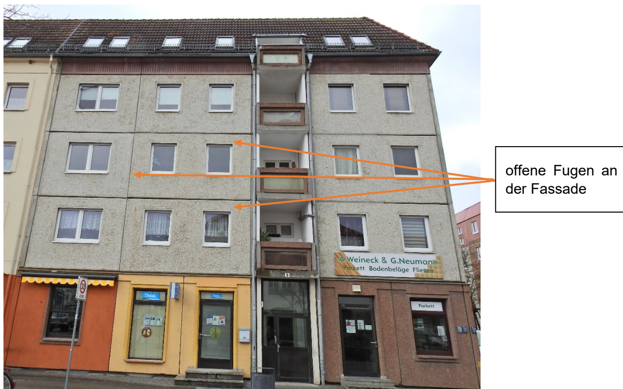
Abbildung 5: Am Markt 5 - offene Fugen zwischen den Fassadenplatten
