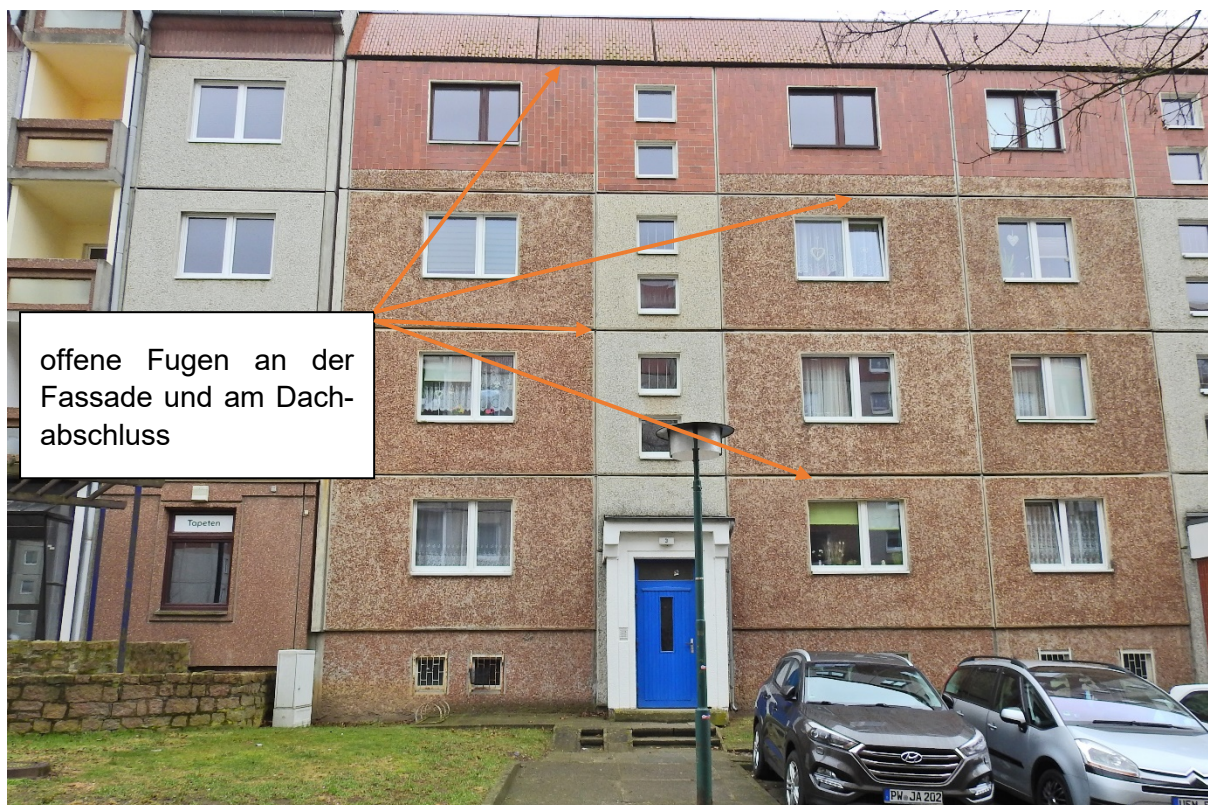
Abbildung 6: Rossstraße 3 - offene Fugen zwischen den Fassadenplatten und am Dachabschluss
