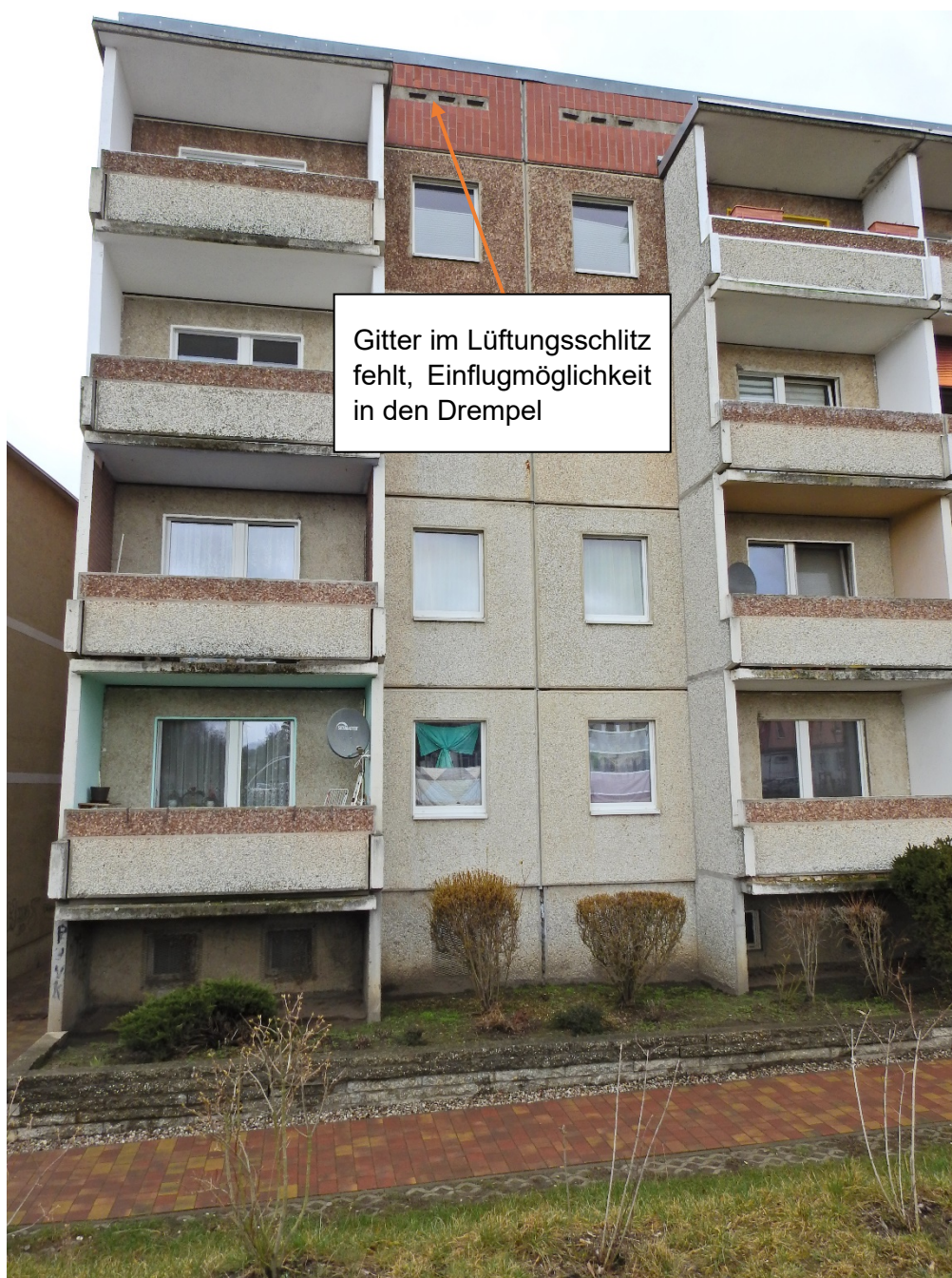
Abbildung 8: Rückseite Rossstraße 9 - Lüftungsschlitz im Drempel offen
