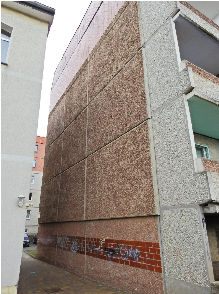
Abbildung 7: Rossstraße 9 - Seitenwand mit offenen Fassadenfugen
