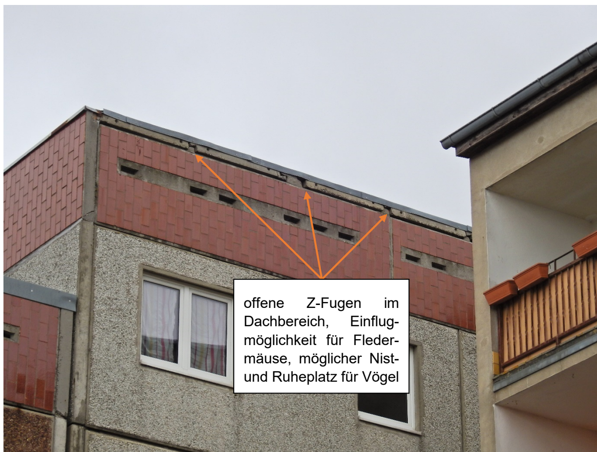
Abbildung 9: Rückseite Rossstraße 1 - offene Z-Fugen im Dachbereich
